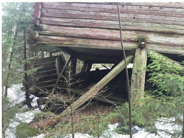
Tröskladans nordöstra hörn saknade stöd. Hörnstolpen hade rasat ner.
