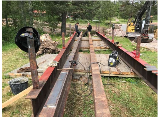
Endast de två mellersta balkarna var rostskadade.
