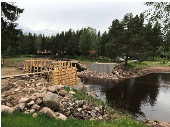
Västra landfästet fyllt med sten och grus. Östra landfästet klart för gjutning.
