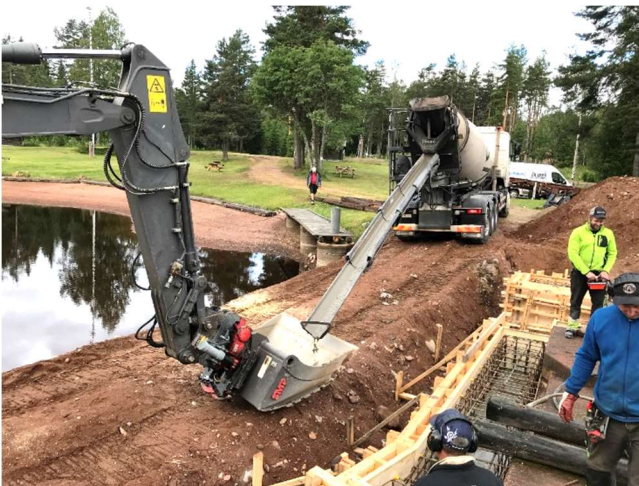
Betong fylls i skopan för gjutning av den del dit betongbilens ränna inte når.
