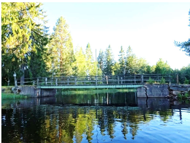
Södra bron före renovering. Det spruckna västra landfästet till höger i bild.
