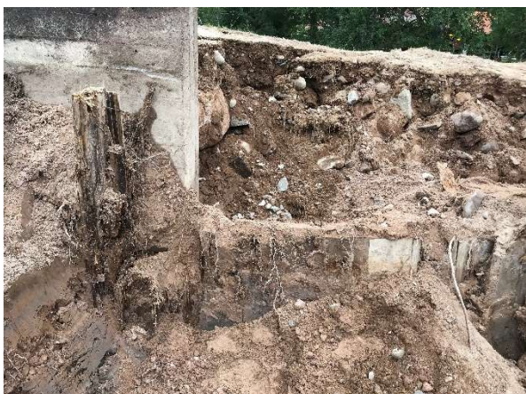
Den gamla träsponten var murken.
