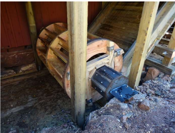
Det nya vattenhjulet med yttre lager. 12 okt 2013.
