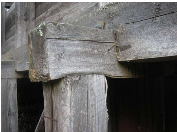
Tvårbalkarna var så murkna att de inte klarade upplagstrycket mot stolparna.
