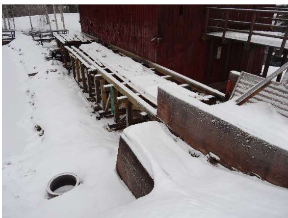
Arbete utfört under hösten 2012. Den nya rännans stomme uppströms ifrån. Fotot taget jan 2013.
