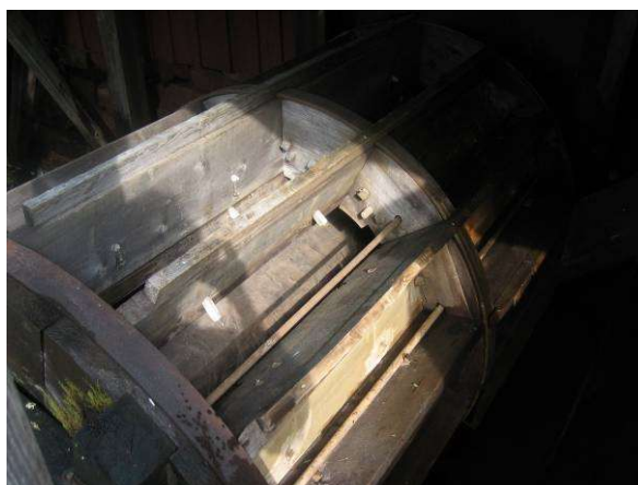
Även själva underfallshjulet var i dåligt skick.
